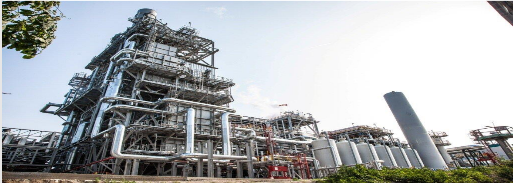
Установка производства водорода методом парового риформинга
