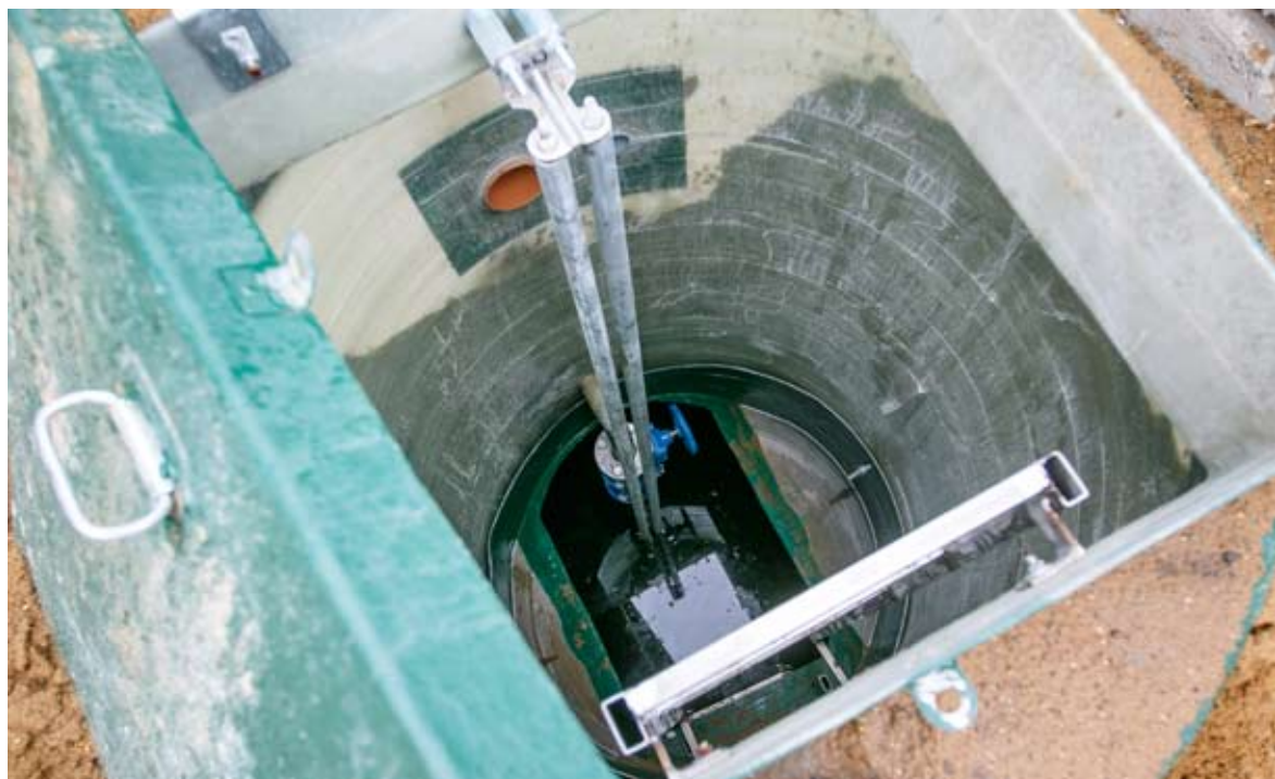
Для подачи фильтрата построены насосные станции.
